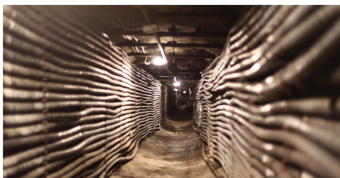
Damjanich áramátalakító kábelagút
